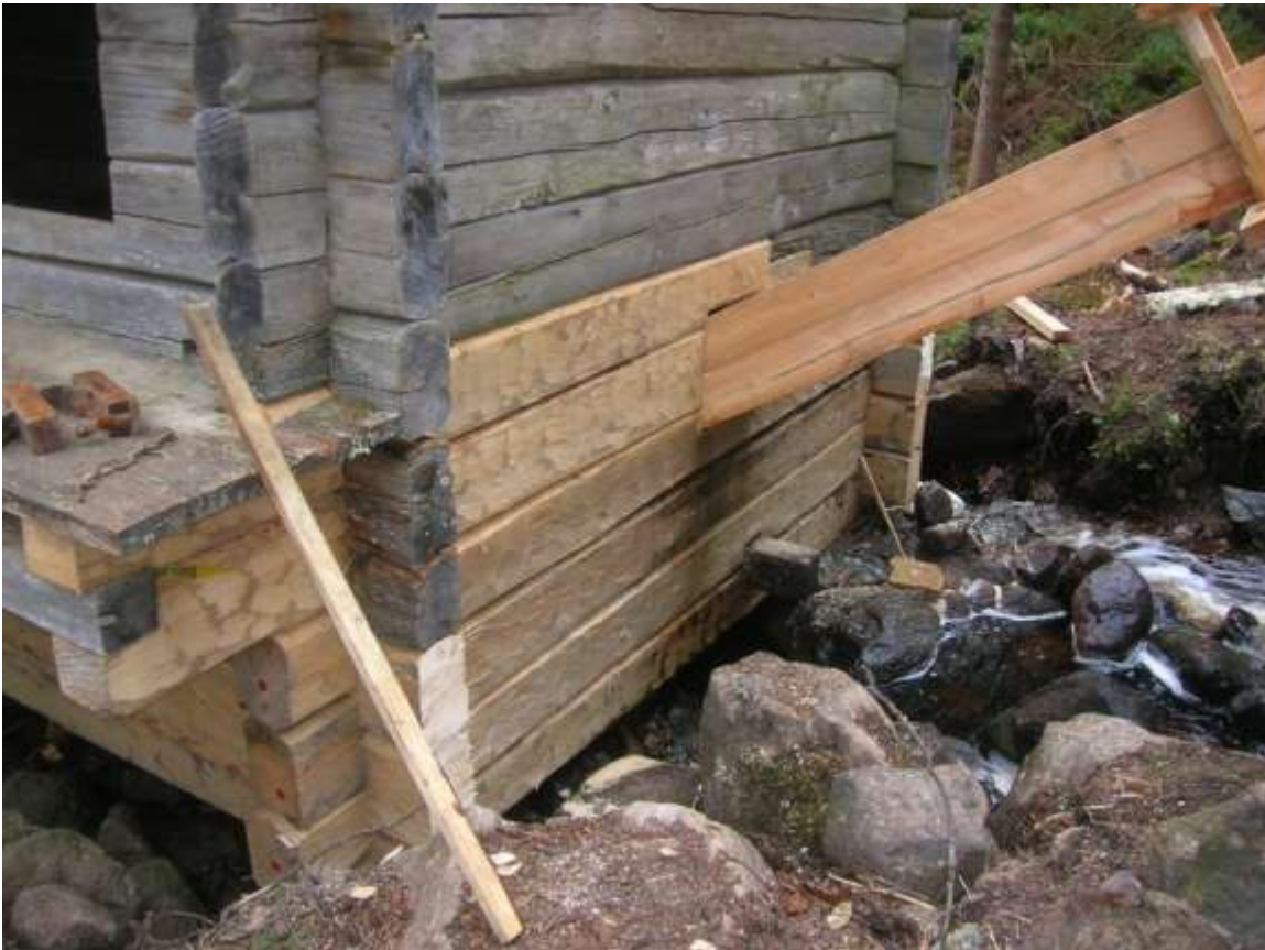
2011-10-12. Vattenrännan går in genom luckan till kvarnhjulet i underbyggnaden.
