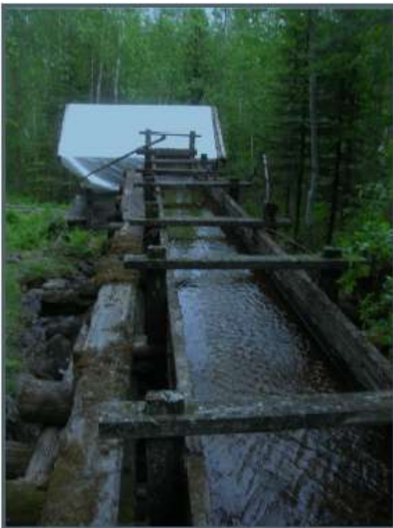
2011-06-14. Rötskador och mosspåväxt på vattenrännans bräder och timmer.
