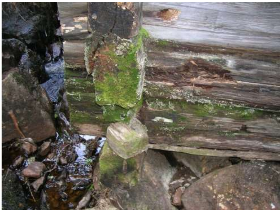
2011-06-14. Rötskador på SO knuten.
