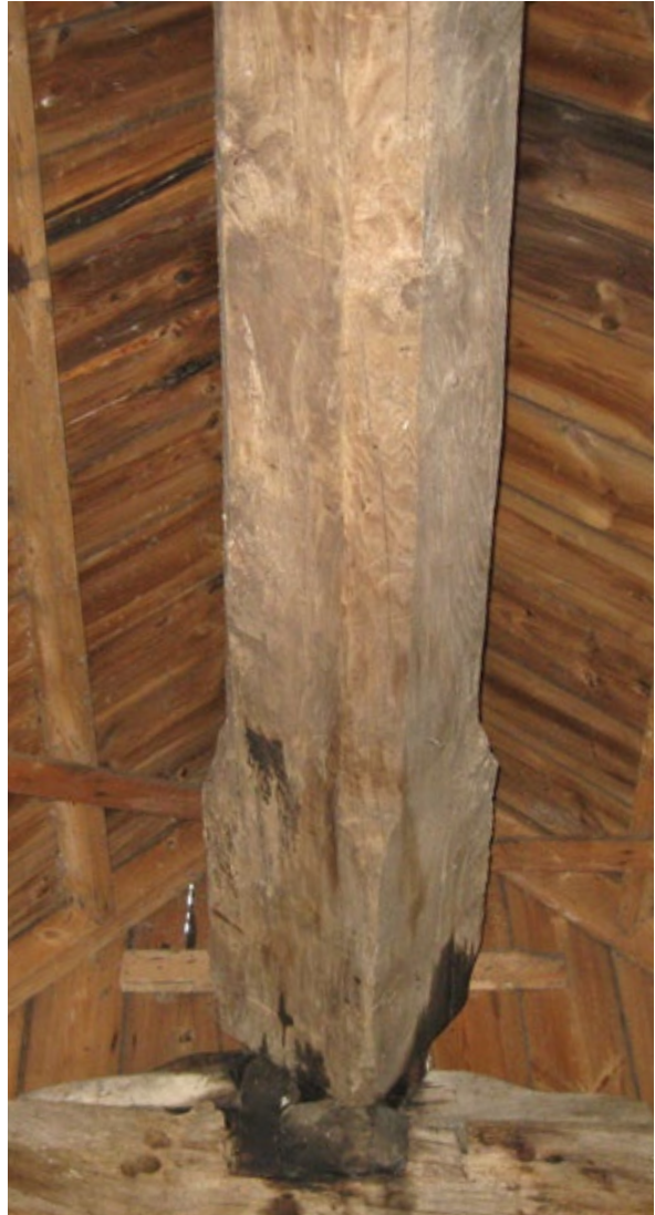
Gångåsen sedd inifrån, före byte.
