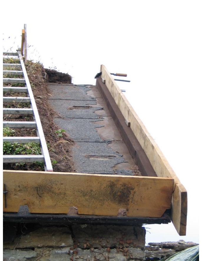
Den underliggande takpappen var skadad utmed kanterna.
