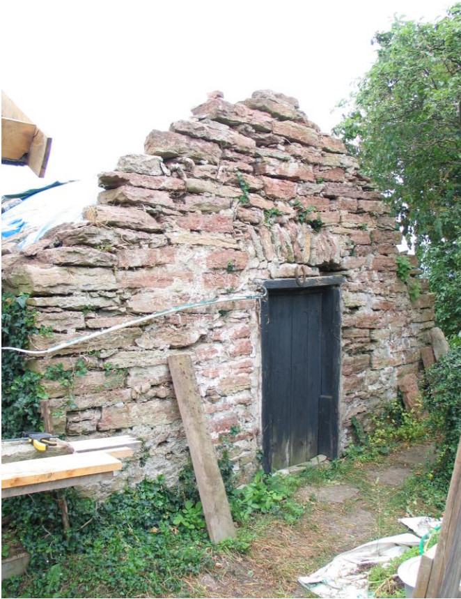
Ovan: Källarens valv var täckt med en presenning sedan 2006 då lager med lera-sjöslak-lera lades.
