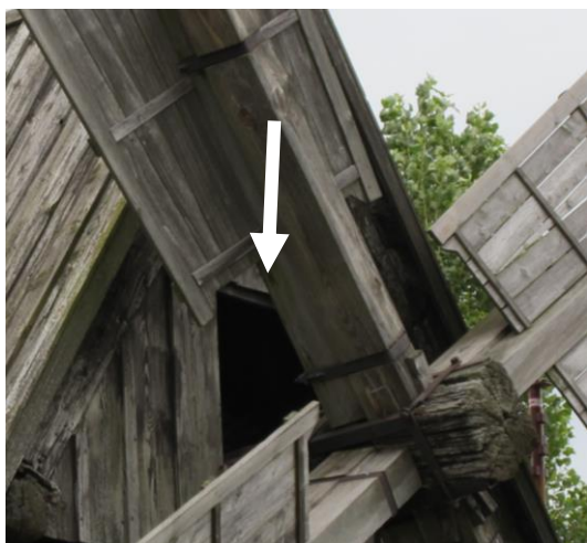
Före: Lucka saknades.
