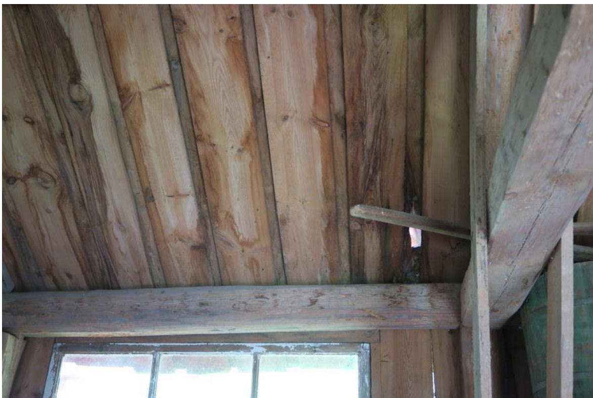
Undertaket med en mindre skada.
