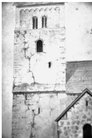
Spricka i Högby gamla kyrkas torn enligt Nyströms uppmättningsritning 1872.
